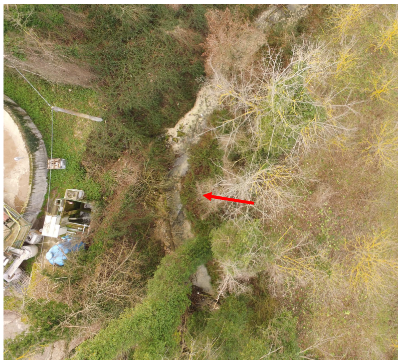
Foto n°2 – Smottamenti che hanno deviato il corso del torrente
