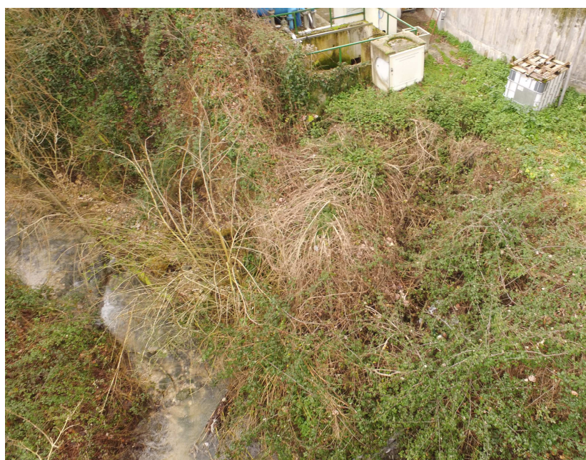
Foto n°6 – Nicchie di frana a ridosso del fabbricato servizi e della vasca di disinfezione
